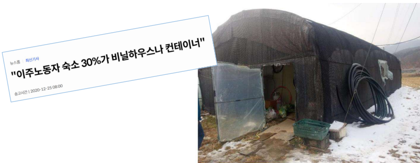
최근 이주노동여성들이 사밀한 사건의 발생한 경기도 한 농가의 비닐하우스 구조 숙소. [이주노동단체 제공]
